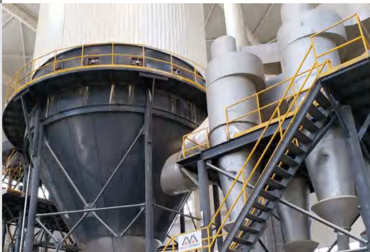
喷雾塔 | Spray Dryer
